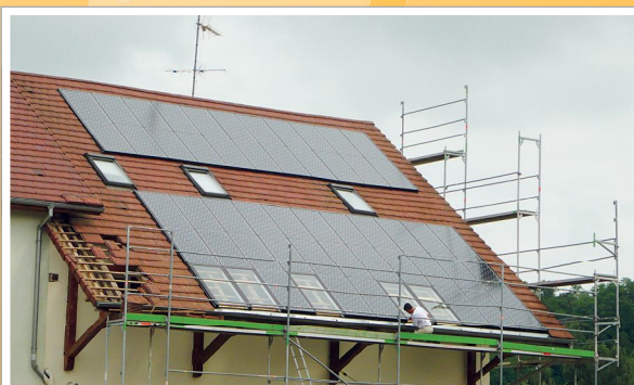
Centrale de 12 kWc sur une maison d'habitation, Alsace
